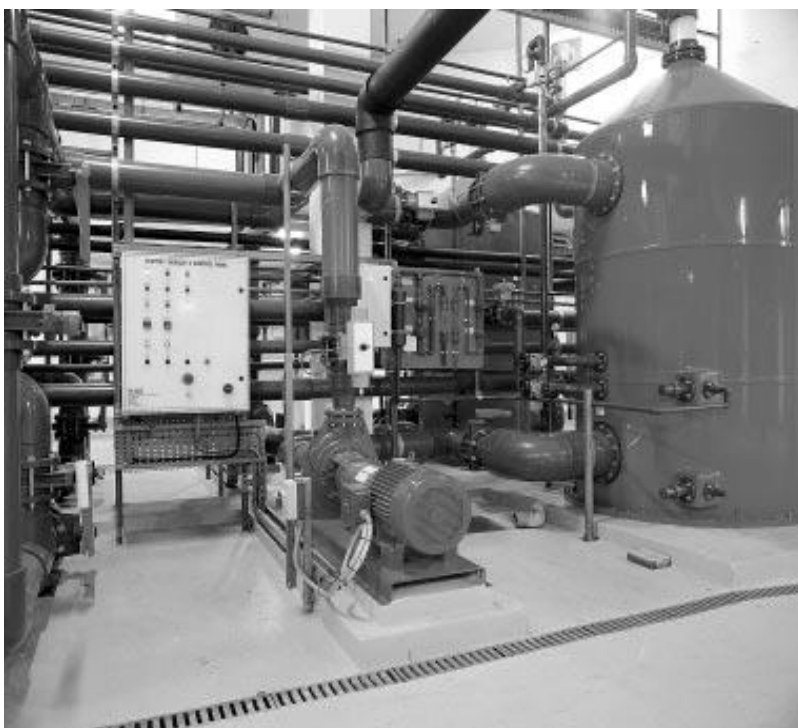
Teilansicht eines der zahlreichen Maschinenräume.
